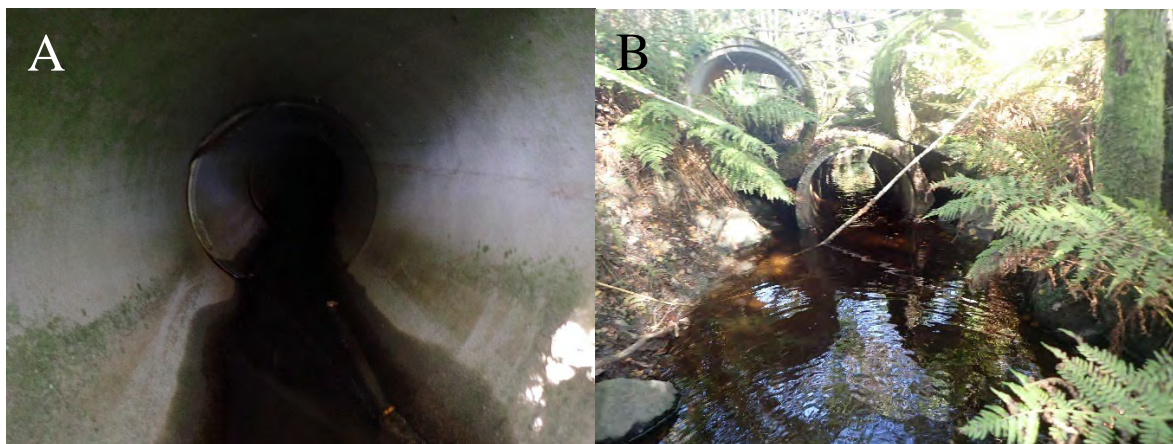
Figur 40. Kulverter i Skumpatjørnbekken. A: Innløp til kulvert i segment 1. B: Lavtliggende kulvert med substrat.
