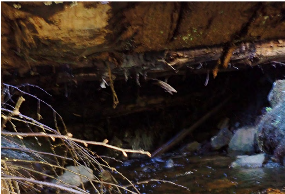
Figur 53. Mulig kunstig temporært vandringshinder. Bilde tatt fra nedsiden av broen. Innerst kan man skimte vannet som renner ut av røret.
