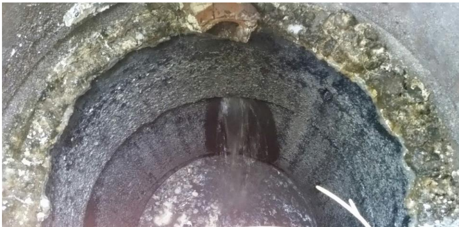
Figur 6: Utett anlegg med vanninntrenging. Dette fører til kortere oppholdstid for avløpsvannet i anlegget, og forstyrrer renseprosessen.
