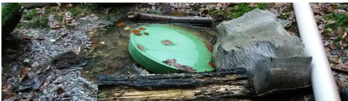
Figur 5: Tett utløp og løst lokk på slamavskiller, fører til oppstuvning av urensset avløpsvann på bakken.
