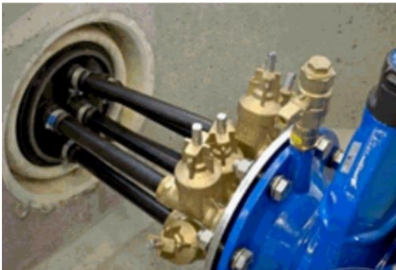
Figur 9. Eksempel på stikkledninger som ligger buntet sammen
