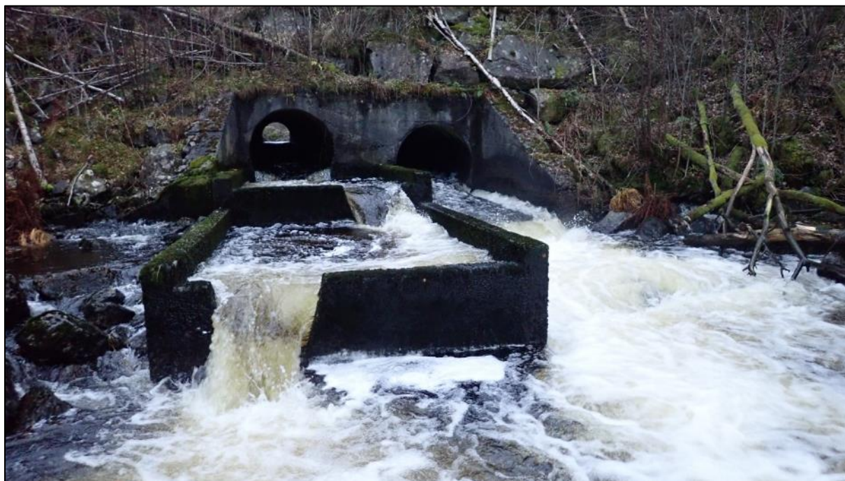
Figur 12.3. Rør med fisketrapp nederst i Svinalivassdraget. Vannet renner gjennom begge rørene, men fisk kan kun passere gjennom røret til venstre.
