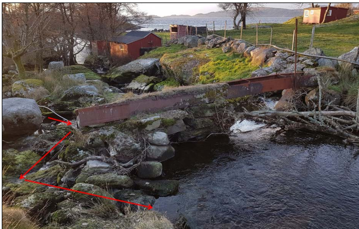
Figur 13. Demningen nederst i Årvikelva, sett ovenfra på lav vannføring. Om demningen ikke kan fjernes, kan oppvandringsforholdene bedres ved å fjerne trebjelken som ligger like under vannflaten, på tvers av åpningen hvor vannet renner ut. I tillegg bør mer vann slippes inn i sideløpet ved å fjerne stein på venstre siden av demningen (røde piler illustrerer hvor fisken da kan vandre opp).
