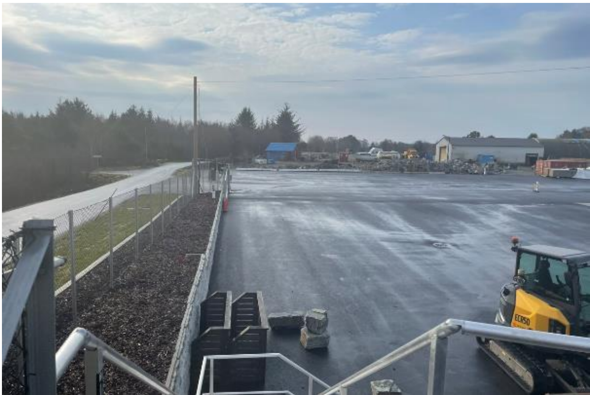
Figur 6 Bilde av dagens situasjon, sett fra grensen mellom gnr. 1 bnr. 151 og 146. Den søndre delen av industriparken, som i hovedsak benyttes til lagring, ses i bakkant av asfaltert areal.
